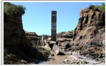
Brèche dans la digue de l'étang de Feneyroux le 15/07/2014
